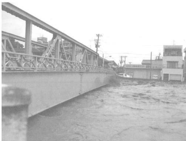
冠水寸前、氾濫15分前の中島大橋
